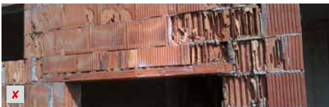
Oštećeni zid od cigle
